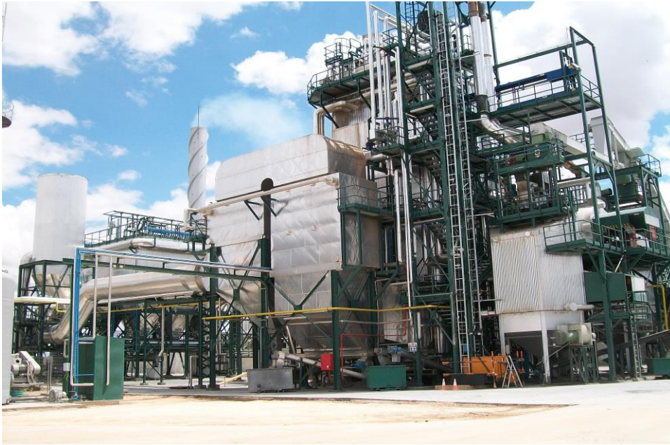
Villacañas 1: Castilla la Mancha (España). Generación eléctrica con caldera de biomasa (residuos de poda, aserraderos, etc)
