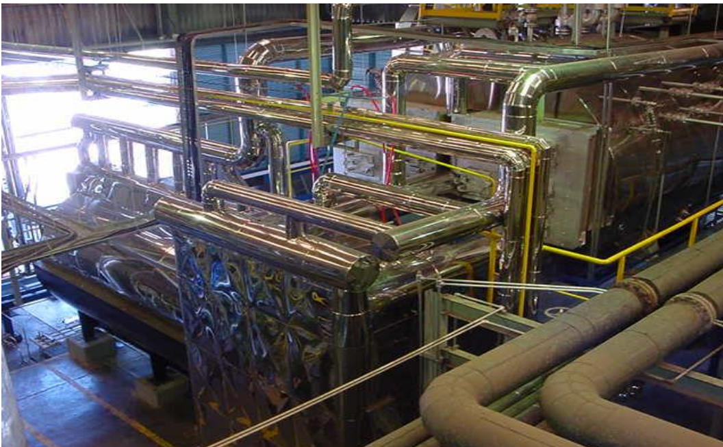
Cervecería Quilmes, Corrientes: Cámara torsional quemando aserrín para generación de vapor para proceso de fabricación de cerveza.
