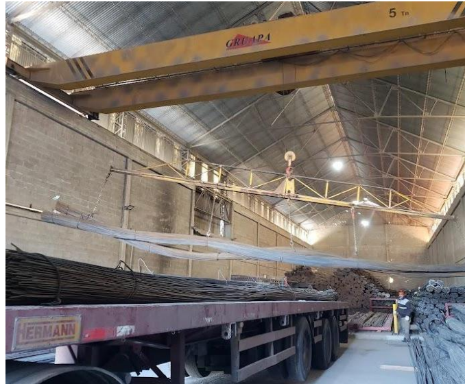
Imagen 18: Puente grúa birraíl
